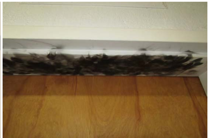
Burn marks on the door frame header
